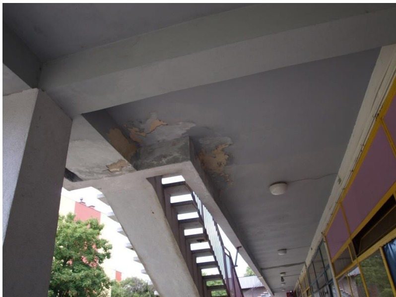
Fot. 12 Zawilgocenia galerii zewnętrznej i schodów
