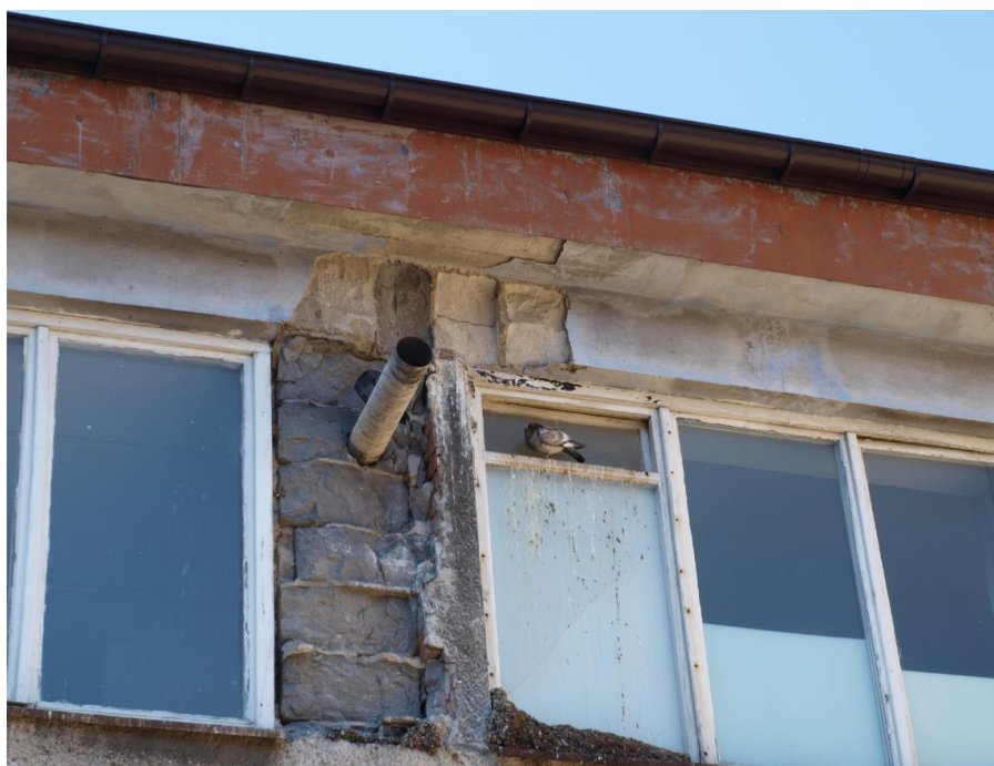
Fot. 15 Uszkodzenia ściany osłonowej
