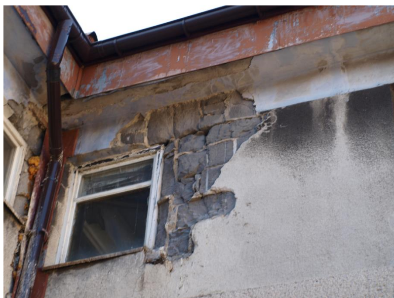
Fot. 14 Uszkodzenia ściany osłonowej
