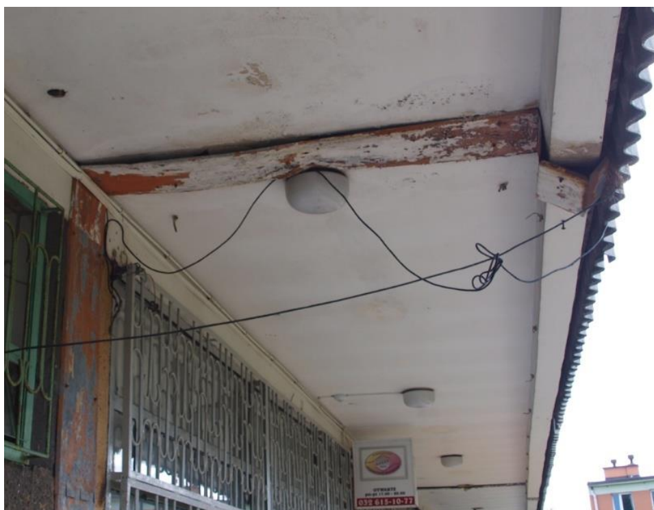
Fot. 16 Uszkodzenia obróbek dylatacji
